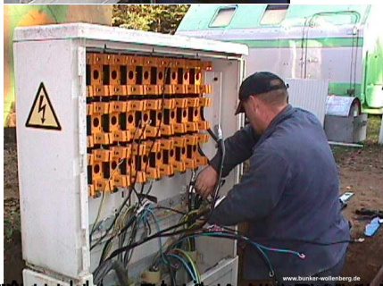
an den Bussteckern des Sockels die Kabel der verschiedenen Bauteile angeschlossen Bunker-Wollberg
